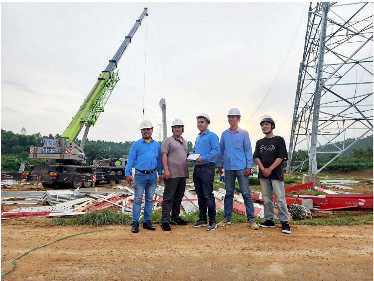
Đồng chí Lê Cao Quyền – Bí Thư Đảng ủy, Chủ tịch HĐQT EVNPECC4 thăm hỏi, động viên người lao động, CBCNV thực hiện công tác giám sát thi công Đường dây 500kV Lào Cai – Vĩnh Yên
